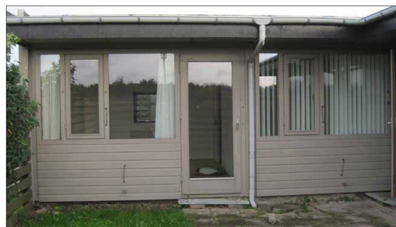
Nedslidte lette facadepartier forårsager også dårligt indeklima pga. træk og kulde.
