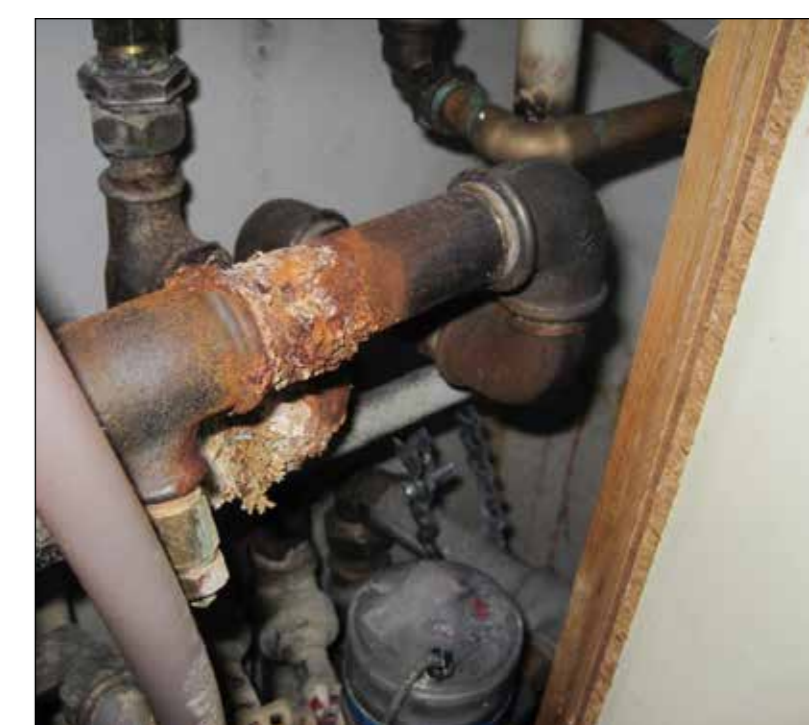
Meget nedslidte installationer.
